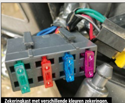
Zekeringkast met verschillende kleuren zekeringen.
